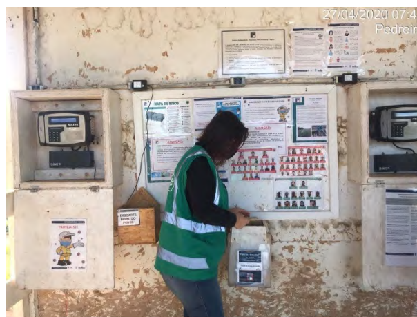
Foto 26 – Caixa de comunicação instalada no canteiro de obras (27/04/20).
