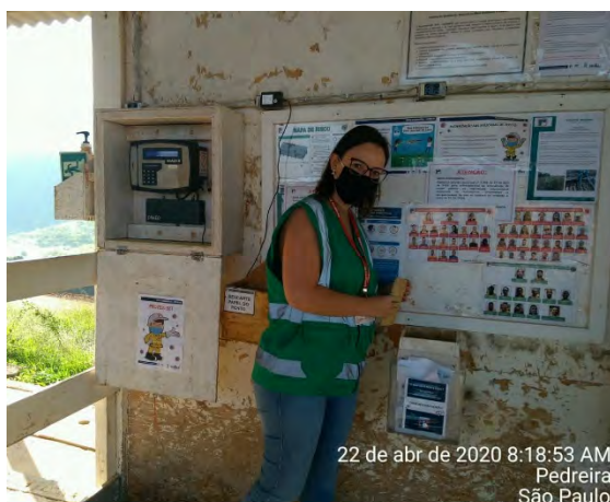
Foto 25 – Caixa de comunicação instalada no canteiro de obras (22/04/20).
