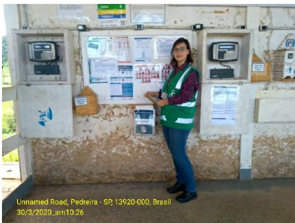
Foto 21 – Caixa de comunicação instalada no canteiro de obras (30/03/20).
